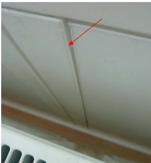
Fig. 16. Nærbillede af det lette brystningsparti bag radiatoren. Der er efterfugtet i samlingerne med klar fugemasse. Afprøvninger med røgpinde sandsynliggjorde at samlingen nu er lufttæt.
