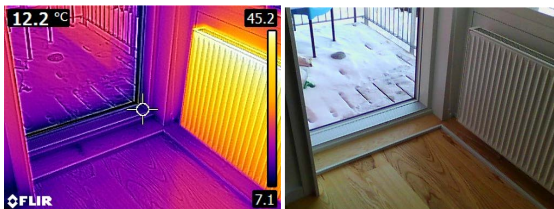
Fig. 20. Termografibillede af areal foran altandør og let parti. Gulvtemperaturen er ca. 12 \text{ }^\circ\text{C} . Målt i lejlighed over krybekælder.
