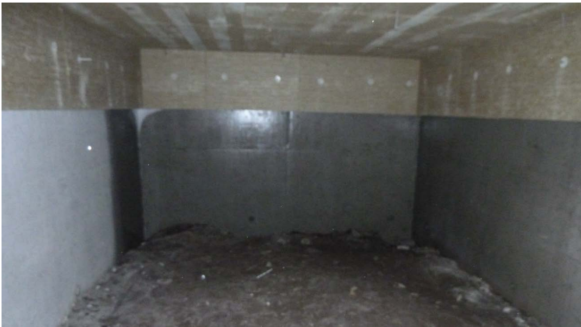
Fig. 26. Krybekælder under nr. 19. Der er isoleret på dæk mod stueetage og ca. 60 cm ned. Endevæggen mod øst er våd, hvilket også gælder den del af skillevæggen, der ligger under karnappen.
