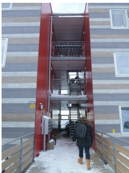
Fig. 25. Trapperum, der ligger mellem blokkens to adskilte bygninger. Der er monteret glasparti til siden mod vandet, men er er åbent til den anden side. Dette betyder bl.a. at der fyger sne ind i trapperummet.
